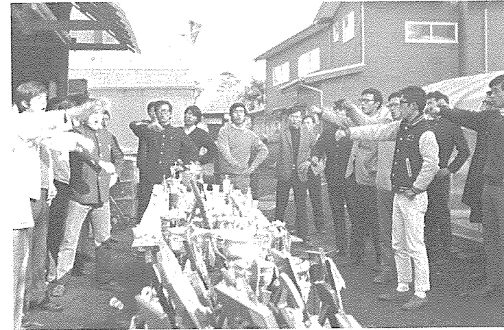
伝統ある部室の解体寸前— トロフィー等をならべ、学 歌を歌い別れをつける— この後1時間程で解体を完 了した。
